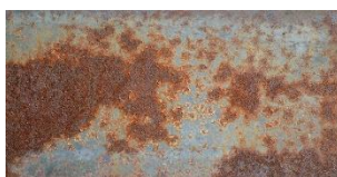
Beginn des Rosteffekts
